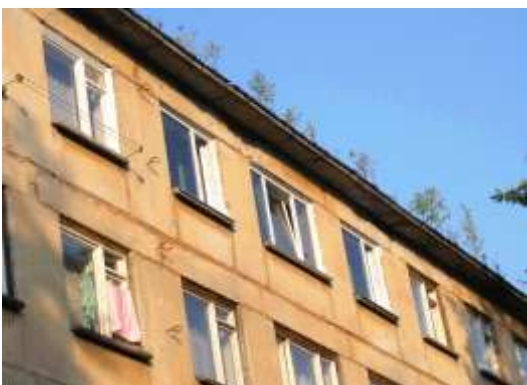
А этот дом еще только надо начинать приводить в порядок - тут на крыше уже деревья выросли...
